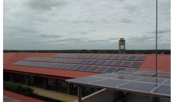
යාපනය විශ්වවිද්‍යාලයේ 60 kWp සූර්ය පද්ධතියක් ස්ථාපිත කිරීම
