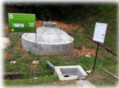
ලං.වි.ම, කොතමලේ බලාගාරයේ ආරක්ෂිත නේවාසිකාගාරය සඳහා 20m 3 Biogas Digester
