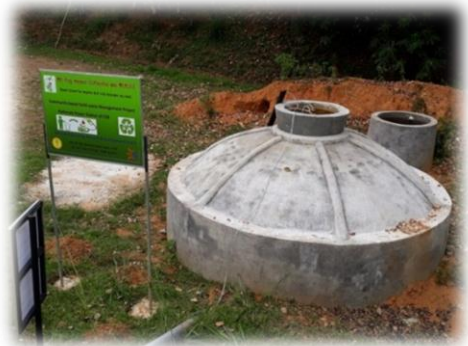
ලං.වි.ම, කොතමලේ බංගලාව සඳහා 20m 3 Biogas Digester
