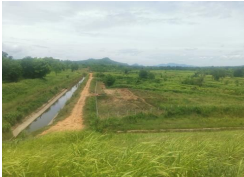
ප්‍රධාන ඇළ බැම්ම මාර්ගයෙහි සංවර්ධන කටයුතු / பிரதான அணைக்கரை சாலையில் வளர்ச்சி பணிகள்/ Development works on the main embankment road
