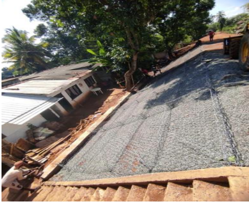
කැලණි උතුරු බැම්ම ප්‍රතිසංස්කරණය කිරීම /களனி வடக்கு கரை புனரமைப்பு/ Kelani North bund rehabilitation
