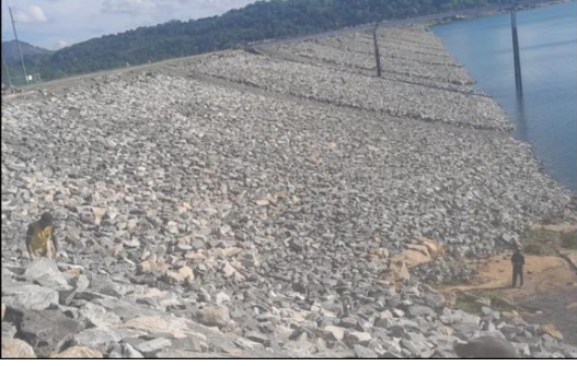
සේනානායක සමුද්‍රය බැම්මට ආරක්ෂාව සැපයීම/அக்கிடாமுறிப்பு அணையை மேம்படுத்துதல் /Providing of Rip-Rap Protection to Senanayaka Samudraya Bund
