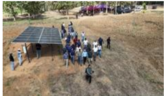
ඡායාරූප අංක 21 - නාරංගල්ල ගොවිපොළෙහි ස්ථාපනය කරන ලද සූර්ය බලශක්තියෙන් ක්‍රියාත්මක වන ජල සම්පාදන පද්ධතිය පුකෙப்பட. எண். 21 - நாரங்கல்ல பண்ணையில் நிறுவப்பட்டுள்ள சூரிய சக்தியில் இயங்கும் நீர் விநியோக அமைப்பு Photo No. 21 - Solar-powered water supply system installed at the Narangalla farm
